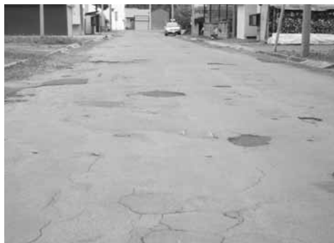
補修を待っている生活道路
