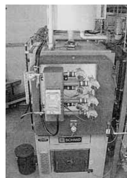
木質バイオマスボイラー (下川町五味温泉)
