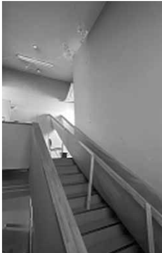
天井付近からの漏水に対応する図書館の様子
