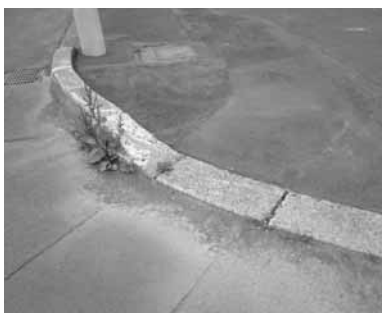
高齢者にとって少しの段差も危険です(歩道の縁石)
