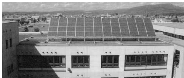
太陽光発電設備（名寄小学校）
