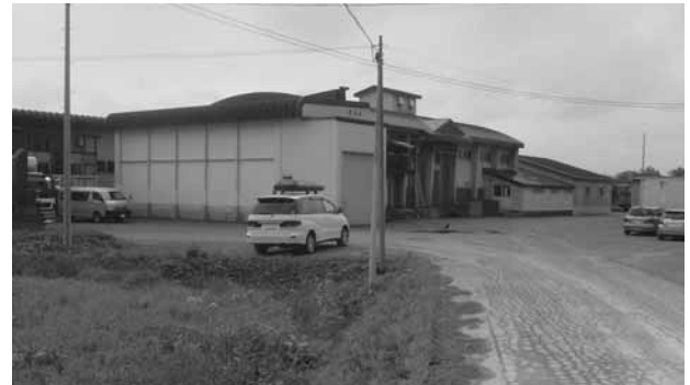
築46年以上が経過して老朽化した食肉センター
