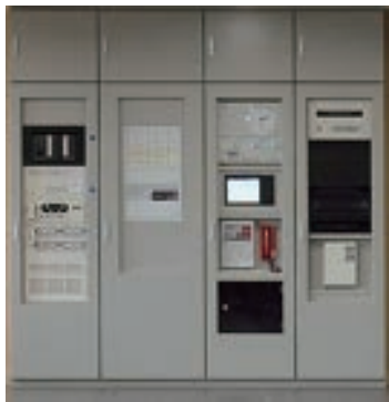
防災複合盤(職員室)
