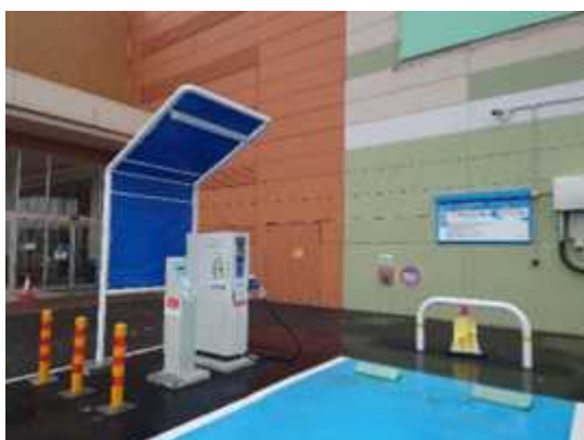
図 7.8 充電器設置事例
