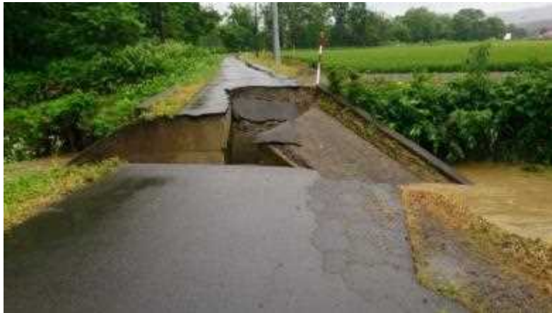
(平成26年8月4日～5日の 大雨による橋の崩落「西風連・初音橋」)
