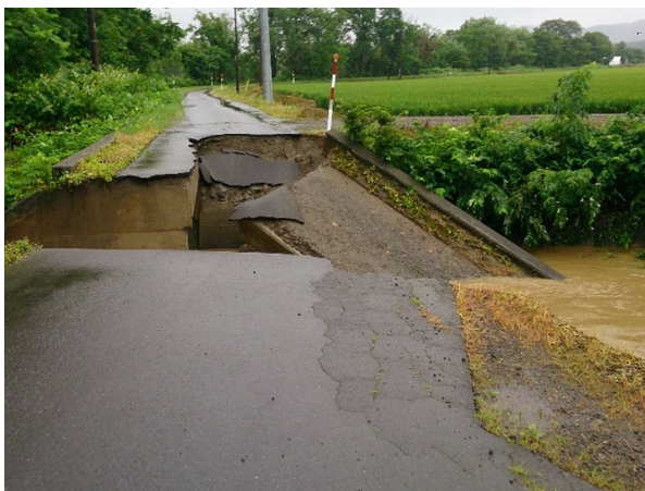
写真1.1 大雨による西風連・初音橋の崩落状況
