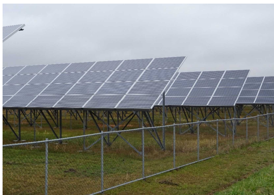
写真 4.1 土地への太陽光発電設備の設置事例
