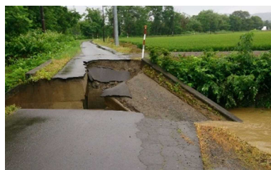
写真 1.1 大雨による西風連・初音橋の崩落状況
