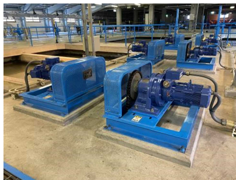
(緑丘浄水場 1・2 拡フロキュレータ減速機)
