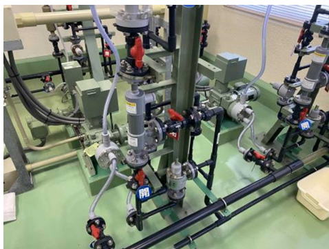
(緑丘浄水場 1・2 拡薬品注入設備)
