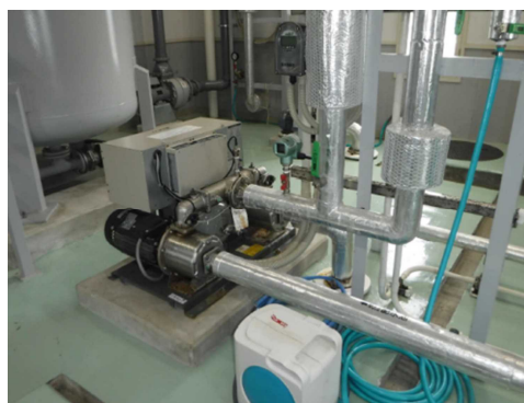
(智恵文中央浄水場 配水ポンプ)
