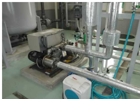
(智恵文中央浄水場 配水ポンプ)
